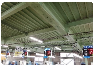
機器設置事例
