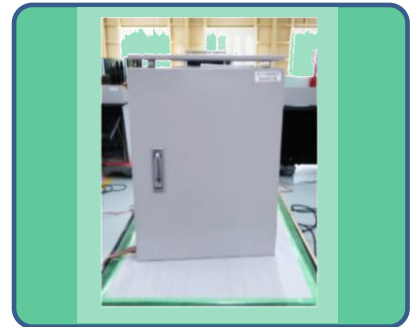
制御装置外観写真
