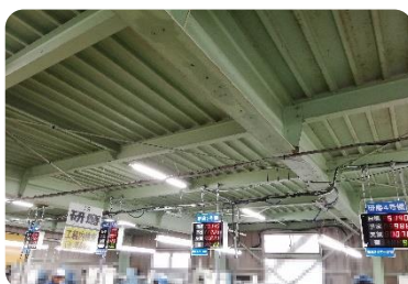
機器設置事例
