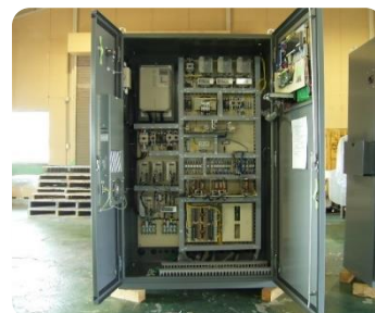
大型制御装置
