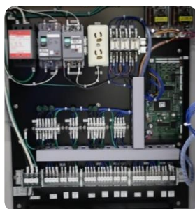
ダム放流制御装置
