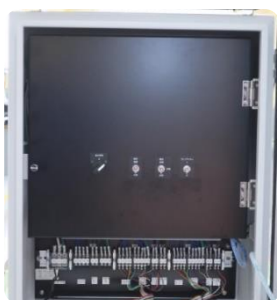
ダム放流制御装置
